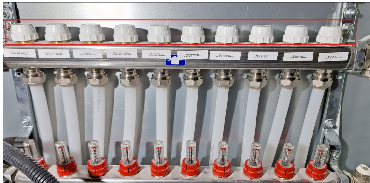
Einstellen der Fußbodenheizung am Rücklaufsegment (rot umrandet)
