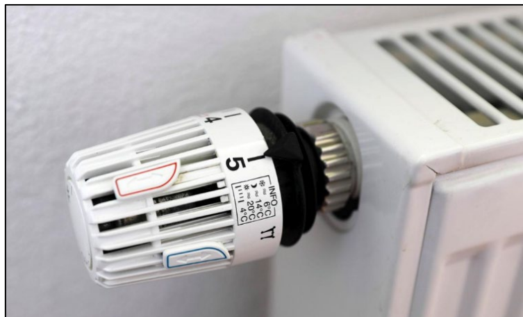
Einstellen von Heizkörpern am Heizkörperventil
